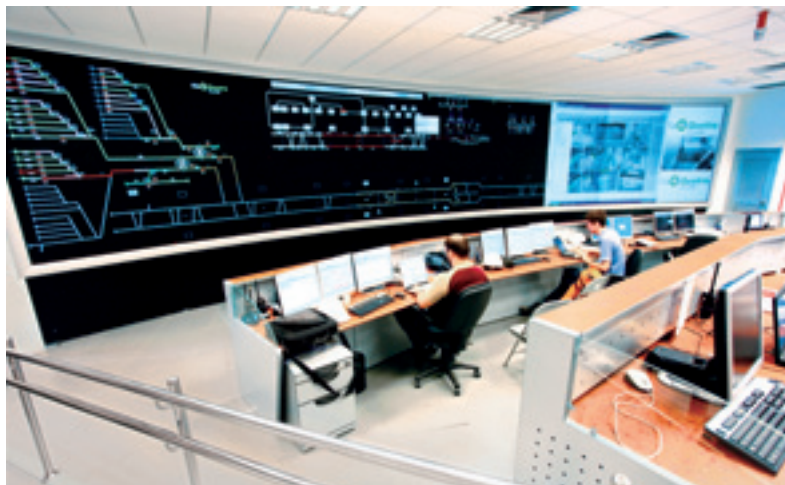
Technik von Siemens: ViaQuatro-Leitwarte in São Paulo.
