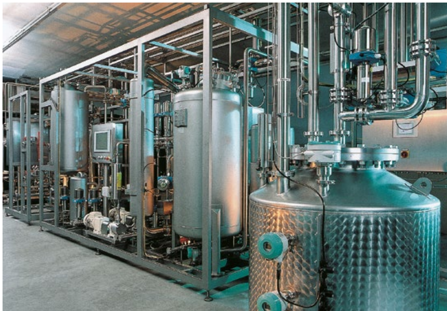
In explosionsgefährdeten Bereichen einer Anlage ist die Einhaltung höchster Sicherheitsstandards verpflichtend
